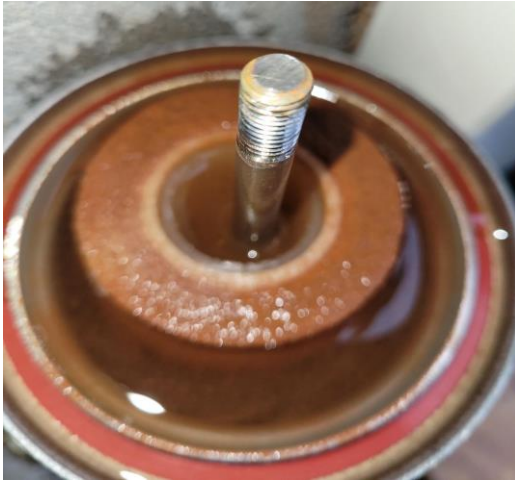
Foto oben: Filter und Kartusche mit der Schmutzbelastung. Der Prozess der Entfernung unerwarteter und unerwünschter Verunreinigungen aus dem Heizsystem hat gerade erst begonnen.
